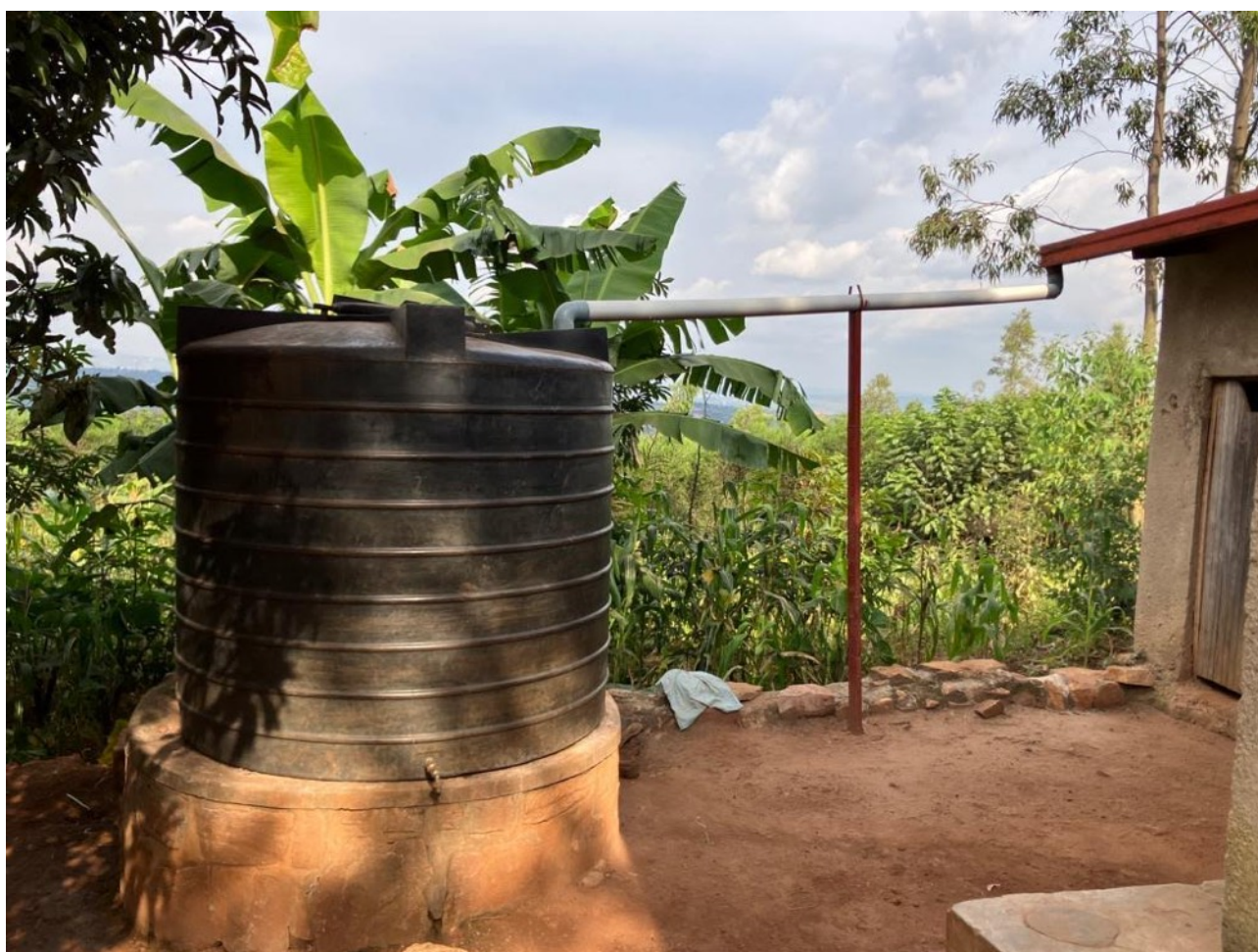
La citerne de récupération d'eau de pluie
